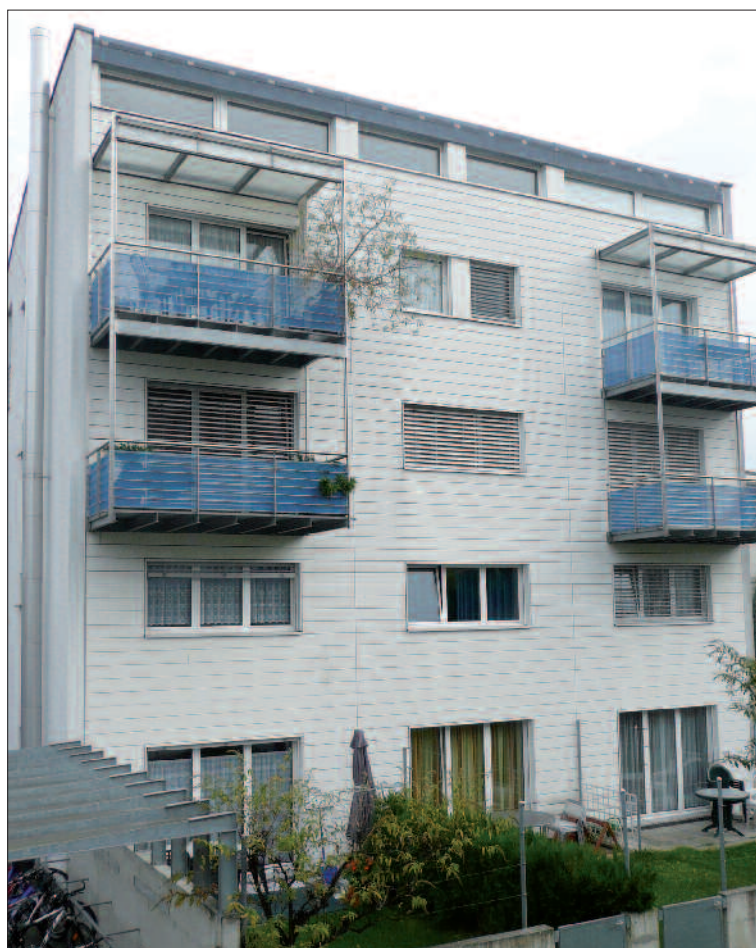
Lames épicéa brossées, traitées industriellement il y a 16 ans avec une peinture couvrante. Aucun entretien n'a été effectué depuis.
