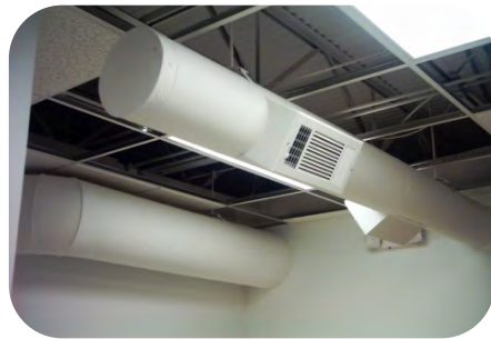
système de climatisation
