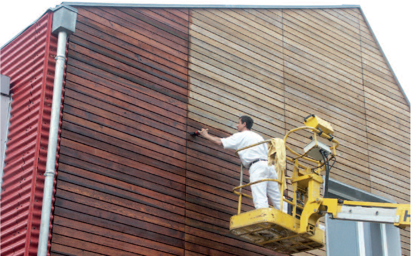
Le choix d'un traitement avec un saturateur n'est judicieux que si la façade est facilement accessible et que l'entretien peut être effectué avec un pont roulant ou une nacelle.
