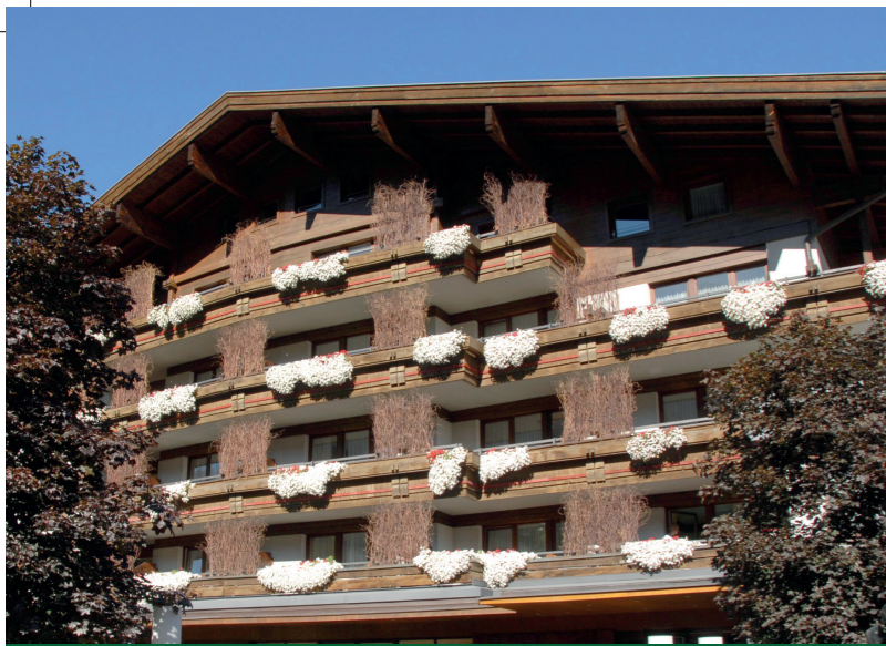
1. Bois dégradés par les intempéries et partiellement infestés par les lichens.
