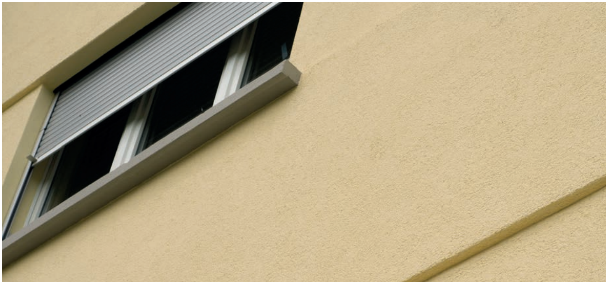
Immeuble d'habitation à Bienne, surface: 1037 m 2 . Structure du système: isolation à la laine de pierre, 16 mm, couche de fond Pura Mortier d'enrobage 426, enrobage des voiles Pura Mortier d'enrobage 426, couche de finition Pura Ribage précieux 402 plein, 2 mm, peinture Peinture silicate bi-composant.
